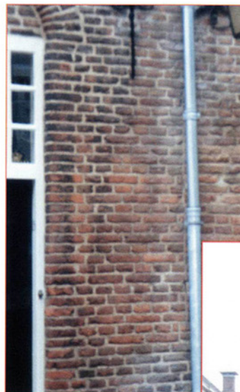
Bouwspoor van een verwijderd kozijn naast de regenpijp.
