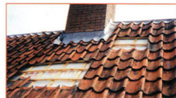
Het aanbrengen van de Oud-Hollandse dakpannen en het opnieuw met lood bedekken van de dok.
